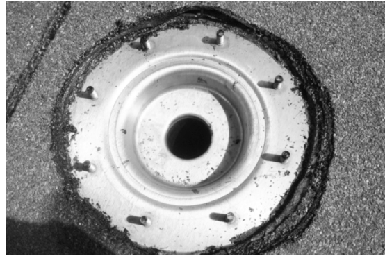
Рисунок Е.3 – Водоизоляционный ковер не наклеен на фланец воронки внутреннего водостока и не обжат другим фланцем
